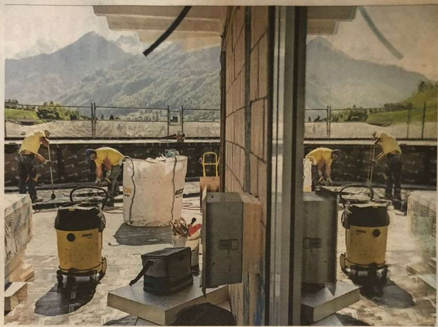
Es gibt noch viel zu tun: Wo Bauarbeiter damit beschäftigt sind, das Flachdach abzudichten, wird in wenigen Monaten eine Dachterrasse mit Ausblick nach Süden in die Berge sein. Bild: Susi Subramaniam
